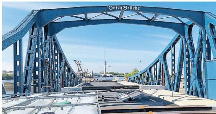
Auch in Wilhelmshaven aktiv: der Emdener Stahlbauer war auch an einer Brückensanierung an der Jade beteiligt.
